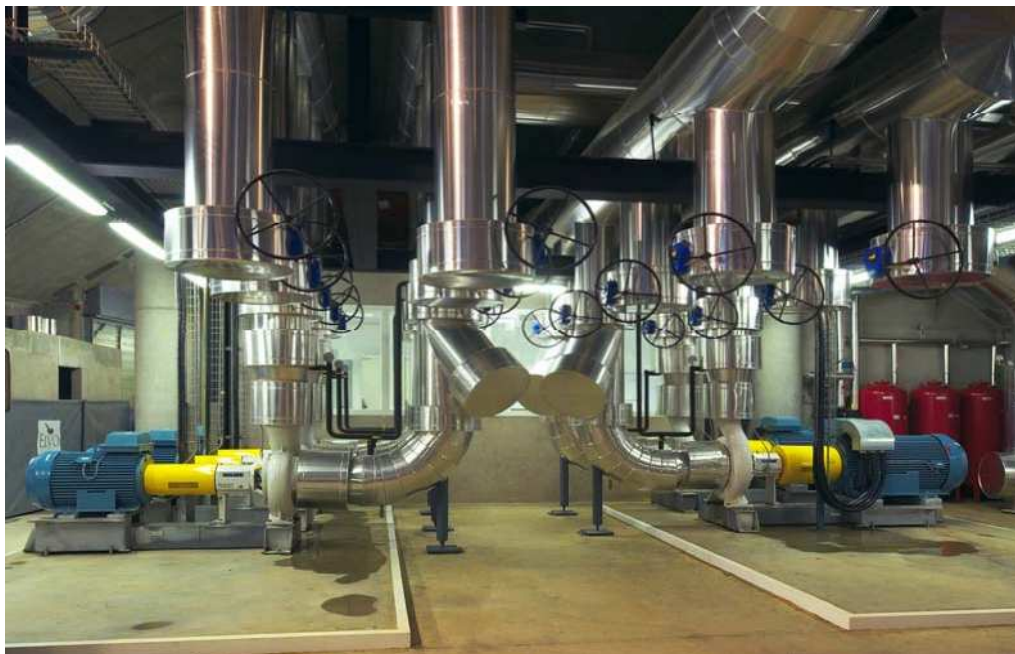
Figura 11. Estación de bombeo del sistema DHC Tub Verd de Mataró (foto superior) y Districlima en Barcelona (foto inferior)
