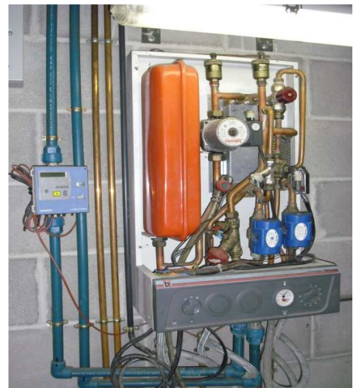
Figura 12. Ejemplo de subestaciones en la central Fòrum-22 @-PERI III Barcelona (izquierda) y "La Granja" en Molins de Rei (derecha)
