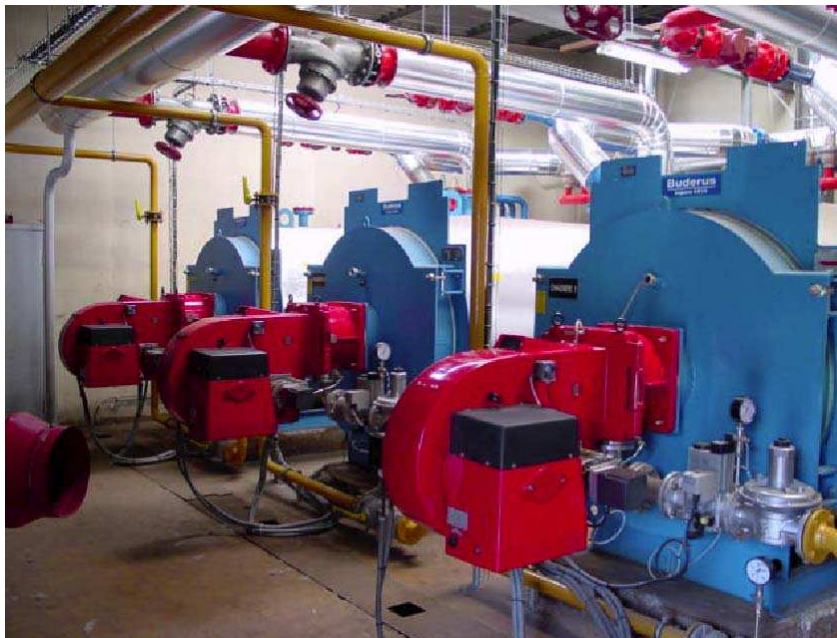
Figura 7. Sala de calderas centralizada. Imagen cedida por Buderus
